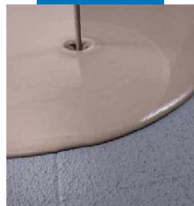
Нанесение самовыравнивающейся шпатлевки на высохший слой Eco Prim Grip, нанесенный на старый пол
