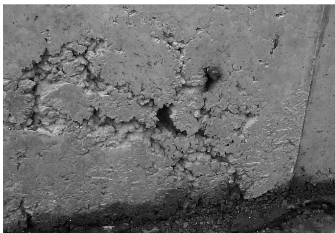
Рис. 4. Непровибрированные участки стены
